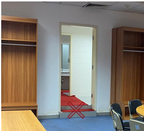
运动员休息室通往卫生间、淋浴间的入口有高差
