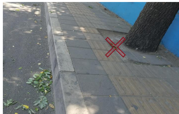
行进盲道上存在障碍物
