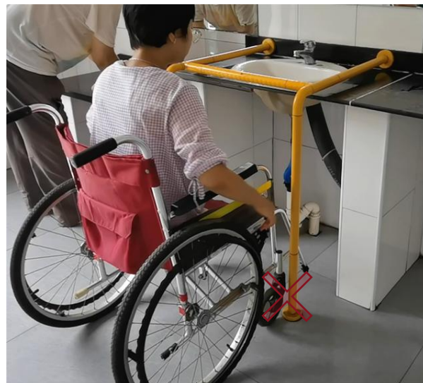
无障碍洗手盆扶手间距不足
