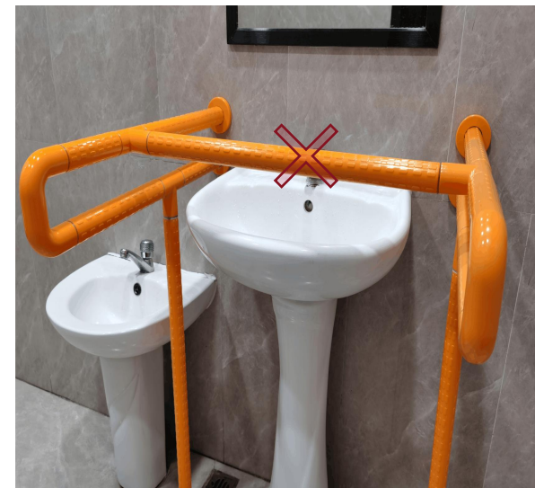
无障碍洗手盆扶手横杆设置过高
