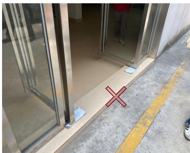
场馆出入口存在高差
