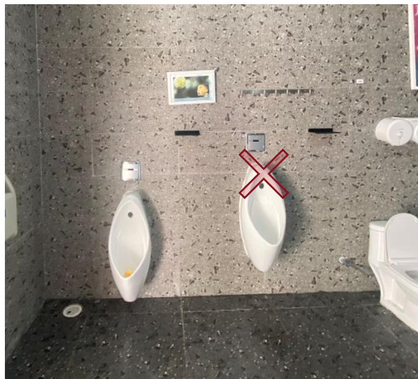
无障碍小便器未设置扶手
