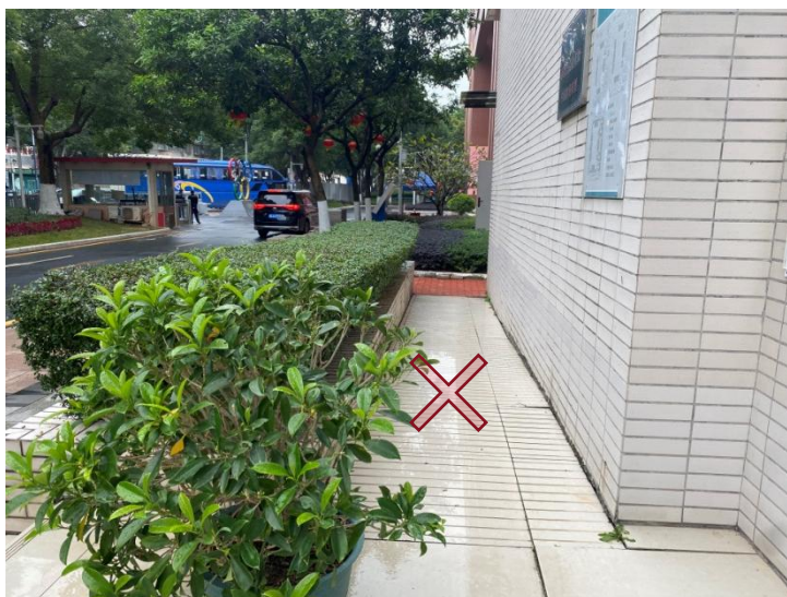
轮椅坡道坡面材料不防滑且未设置扶手
