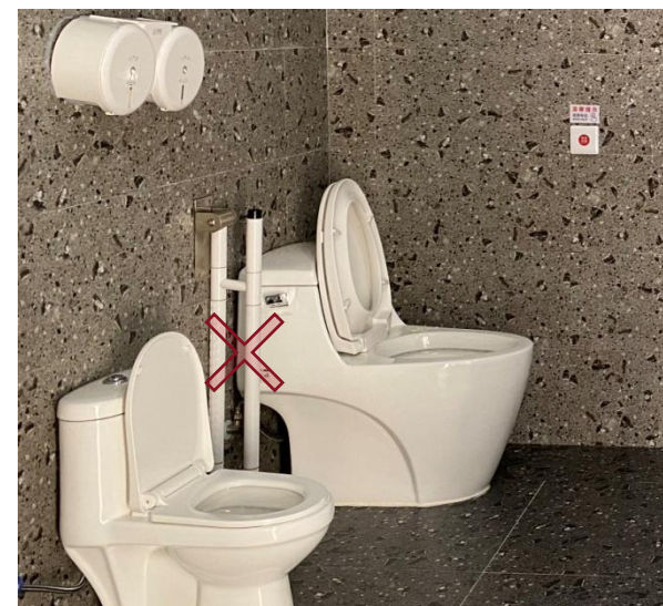
无障碍座便器上下翻转扶手装反
