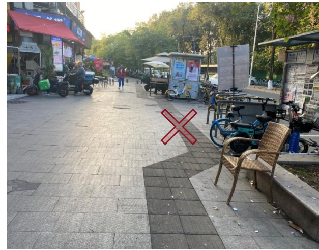
将盲道作为铺装分割未在拐弯处铺设提示盲道
