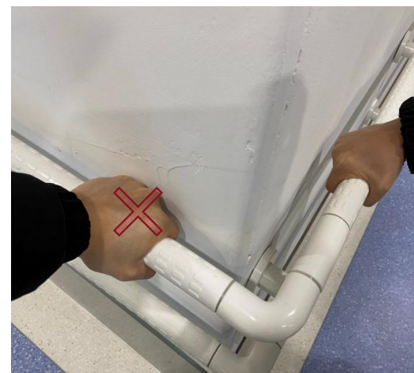
无障碍通道上的扶手距墙间隙不足40mm
